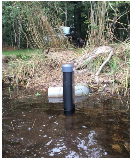
Figuur 20: Oppervlaktewatermeetpunt in Het Goor, bij de duiker die aangebracht is om tijdelijk de waterstand te verlagen.
