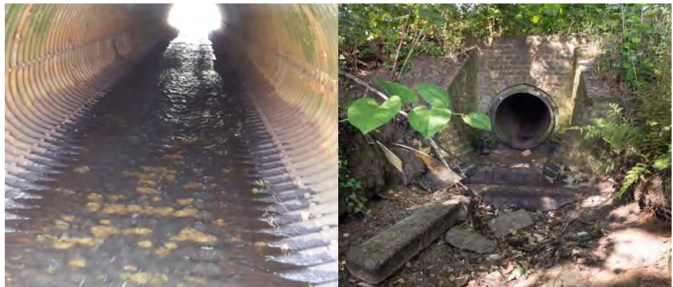
Figuur 1 - Duiker met een te hoge stroomsnelheid over een te lang traject (links) en een duiker met een slechte aansluiting op de bodem (rechts). Bron: Ecogroen (foto links) & Waterschap de Dommel (foto rechts)
